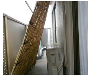
室外機へのよしずがけ
