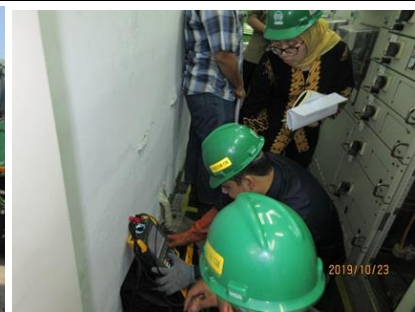
電力測定（水道事業）
