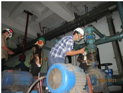
ポンプ流速測定（水道事業）
