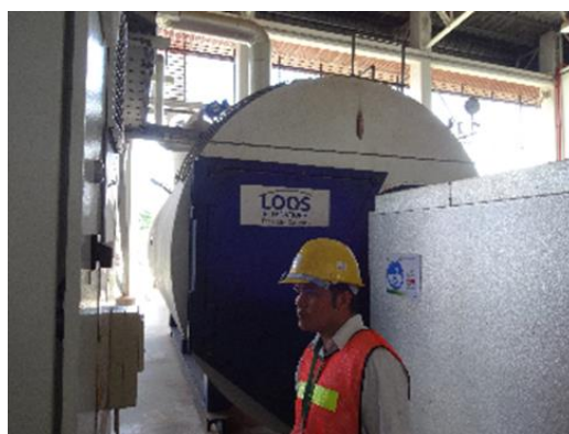
ビール工場・ボイラー
