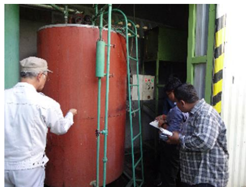
ソース工場・ボイラー壁測温
