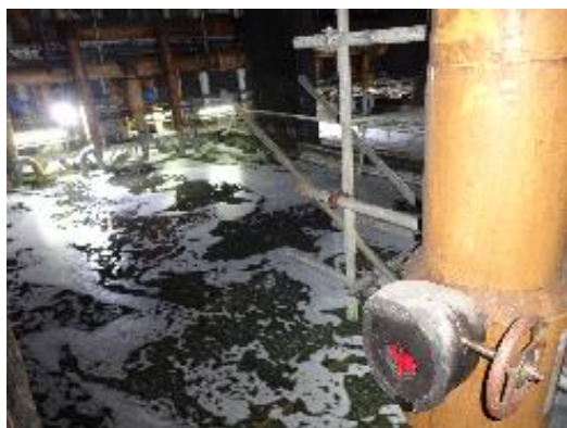
複合ビル（氷蓄熱槽）
